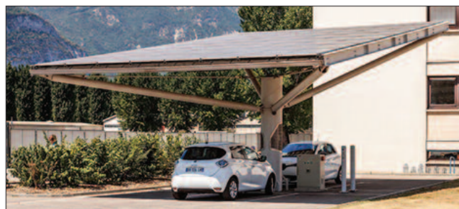
Panneau photovoltaïque à la fois ombrière et chargeur de voiture électrique.
