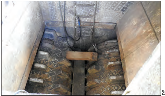
Concasseur primaire Arbed en cours de maintenance.
