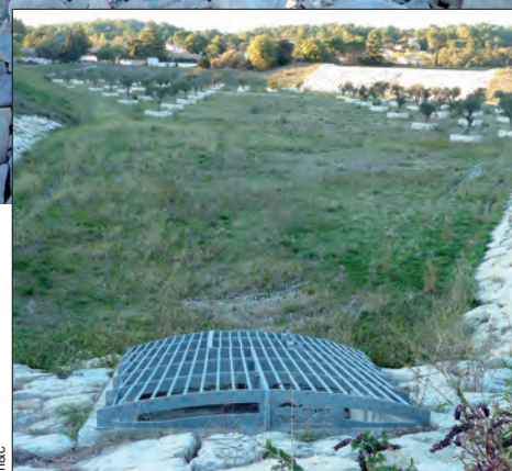
L'aménagement du cadereau des Romarins se traduit par deux bassins de retenue successifs aménagés comme des espaces verts, toujours côté ouest de Nîmes. Travaux de 2006 et une capacité de 53 300 m 3 .
