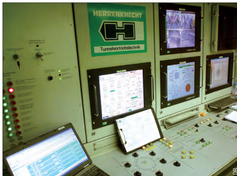
Poste de pilotage du tunnelier. Le choix de ce tunnelier roche dur, de type bouclier à simple jupe, est justifié par la rencontre de terrains affectés par de grandes déformations
