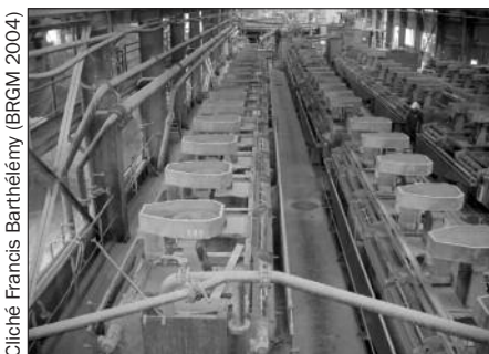
Figure 7 - Cellules Fe flottation dans l'usine de Chaillac.
