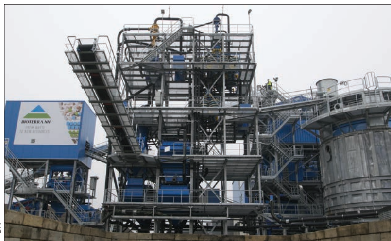
Installation Bioterra de Genk sud, près du canal Albert.
