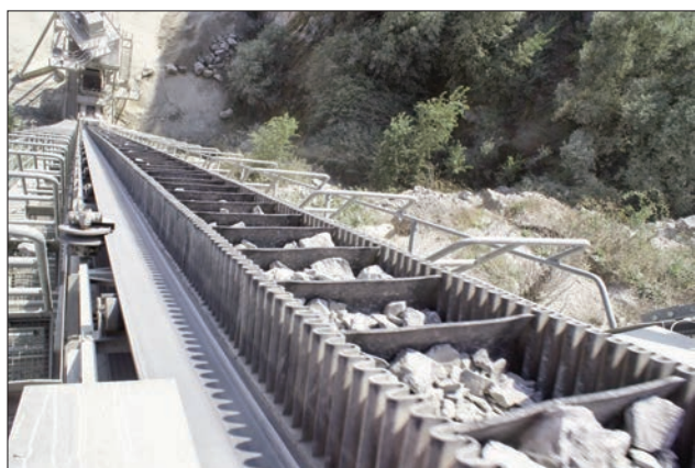
DR Installation de transport par bande.
