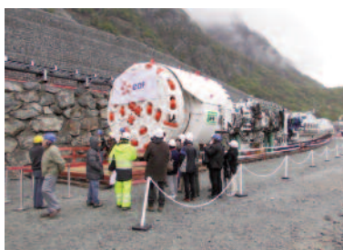
Lilorosa, l'un des deux tunneliers qui œuvrera sur le chantier de l'aménagement hydroélectrique Romanche Gavet à Livet-et-Gavet (38)
